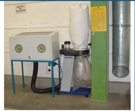
Eine Absaugvorrichtung verhindert das Zusetzen der Filter durch Staub.
